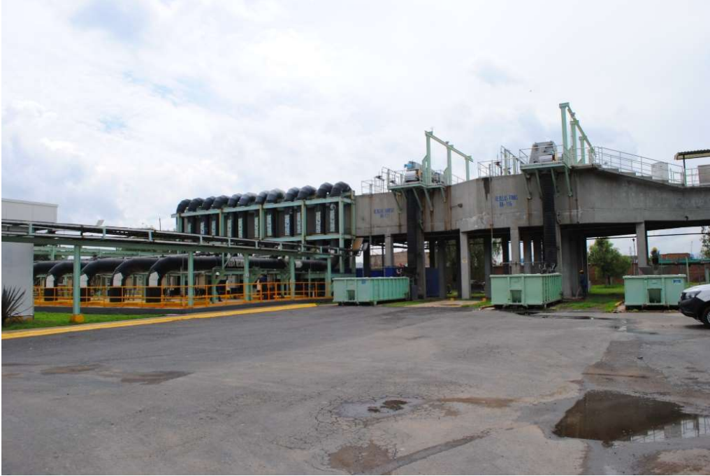
Fotografía 1. Zona de recepción de influente, rejillas gruesas y finas y Parshall de entrada.
