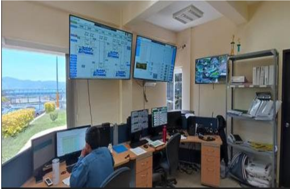
Ilustración 1-11.- Cuarto de control de la PTAR "EL AHOGADO"
